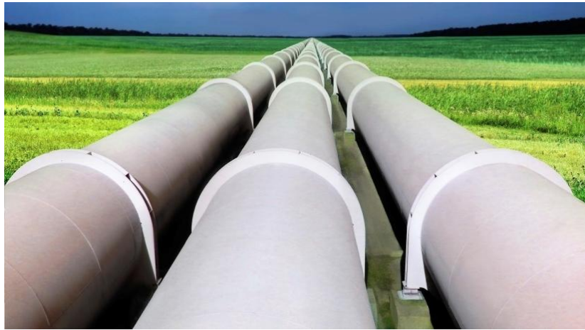
Slika 3.5. Izgled nadzemnog naftovoda
