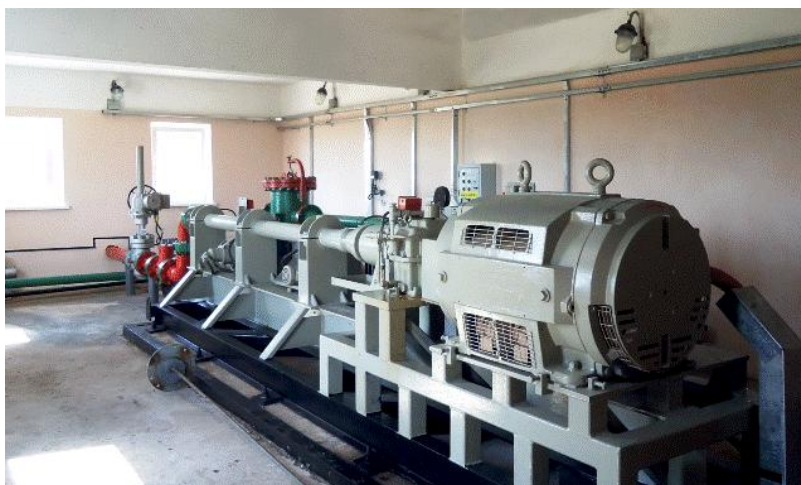
Slika 3.4. Izgled pumpne stanice
